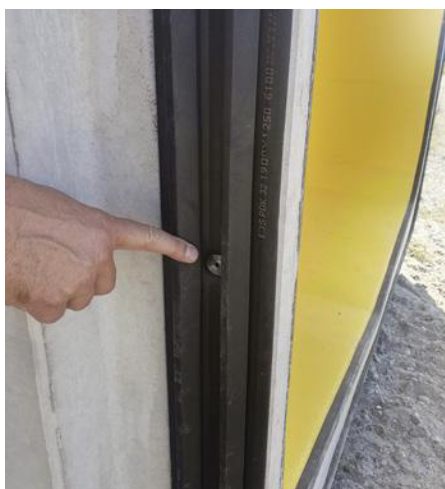
Die Doppeldichtung mit Prüfventilen kann auch später auf Dichtheit geprüft werden. | Foto: B_I/zu Eulenburg
