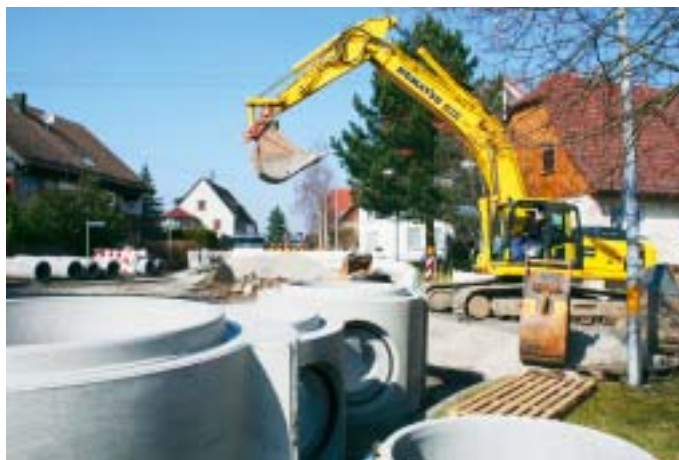
Kanalbau in Neubulach: Perfect-Schachtunterteile DN1200 für den Anschluß von Stahlbetonrohren DN 500. Fotos (2): SB-ARCHIV
