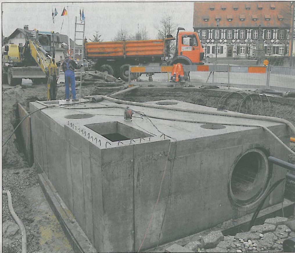
BEI STARKEN NIEDERSCHLÄGEN soll dieses Regenüberlaufbecken in der Rheinstraße im Stadtteil Freistett für Entlastung sorgen. Foto: red
